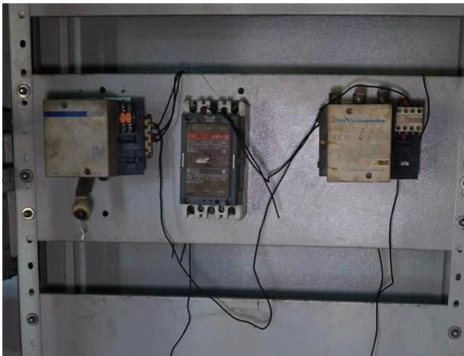
Además del robo, los delincuentes dañaron los equipos. Foto:Alcaldía
