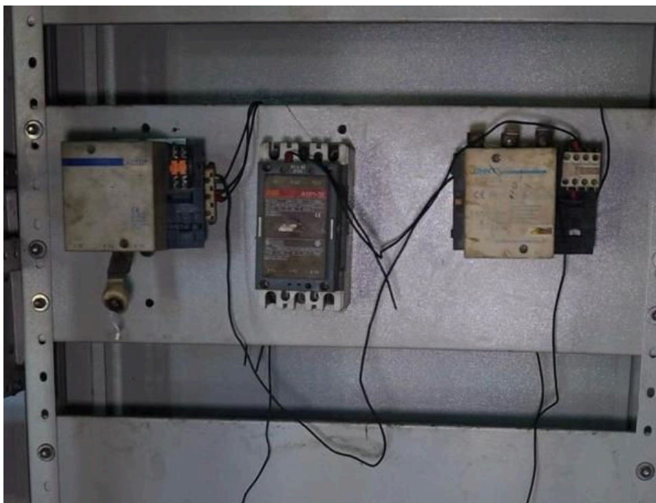
Además del robo, los delincuentes dañaron los equipos.
